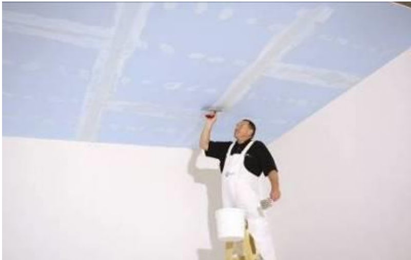
Obr.5: Tmelení modrého akustického sádrokartonového podhledu Rigips. Modré akustické systémy Rigips pomáhají zlepšit zvukovou izolaci v interiérech. Snížení stropu s modrými akustickými deskami Rigips je jen o 5 cm a přinese o výrazných 13 dB lepší zvukově izolační vlastnosti.
