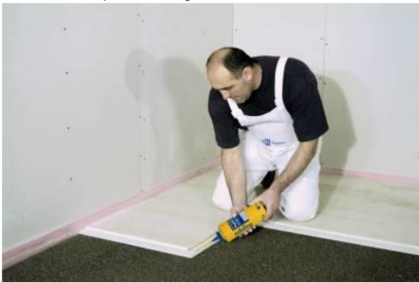
Obr.6: Montáž suché plovoucí sádrovláknité podlahy je rychlá. Podlahy ze sádrovláknitých desek Rigidur mají vysokou tvrdost a pevnost povrchu – vydrží např. zátěž kolečkových židlí. Podlahy jsou pochůzné ihned po vytvrzení lepidel. Po cca 24 hodinách je možné na hotové podlahy položit koberce, linoleum i parkety. Přinášejí tedy značné zrychlení stavebních kroků při výstavbě.
