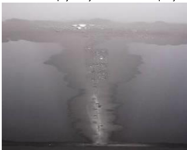
Obr. 1: Průsak vody stropní sádrokartonovou konstrukcí
